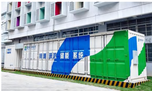
图 2 200kW/800kWh 锌溴液流储能电站
