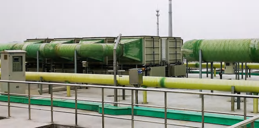
图 2 污水处理厂除臭净化系统工程现场
