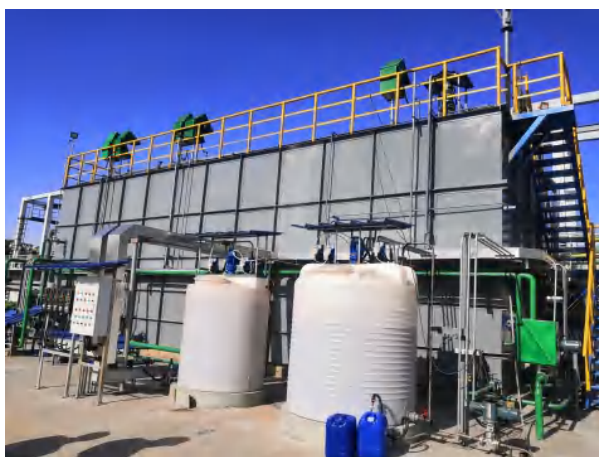
高氮废水处理中试装备图
